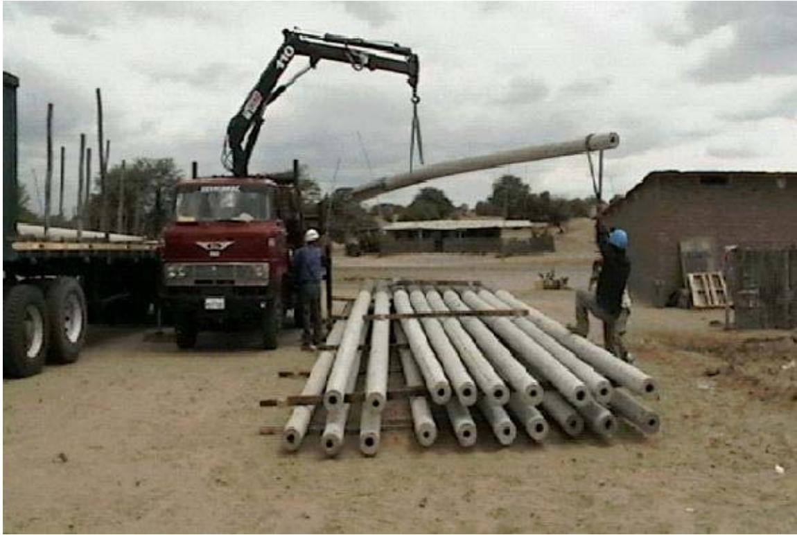
Foto 2: postes para instalación ubicados en Jaqui (Arequipa)
